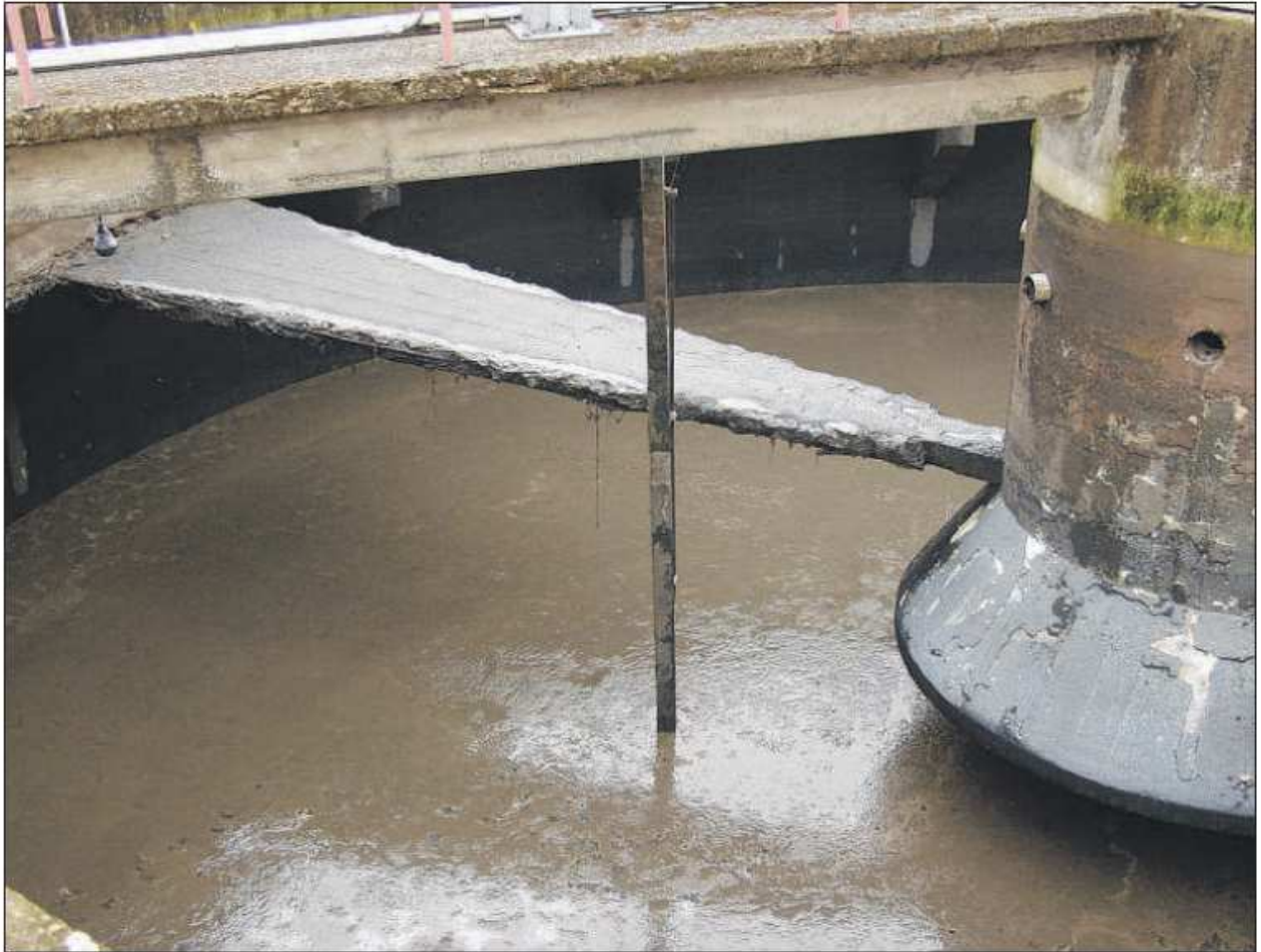
An den Streben im Schlamm Speicher des Schneverdinger Klärwerks liegt die Metallbewehrung schon frei.
