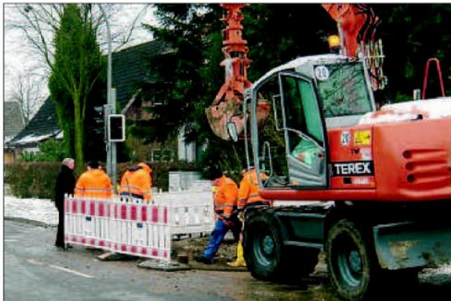
Wasserrohrbruch an der Einmündung Inseler Straße/Am Jordan.
