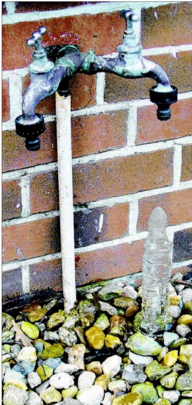
Die nächste Eiszeit kann schon an der Hausecke beginnen, wie dieses Leserfoto belegt. Die Versorgungsfirmen empfehlen rechtzeitige Vorsorge, um Frostschäden zu vermeiden. Foto: Reiner von der Fecht
